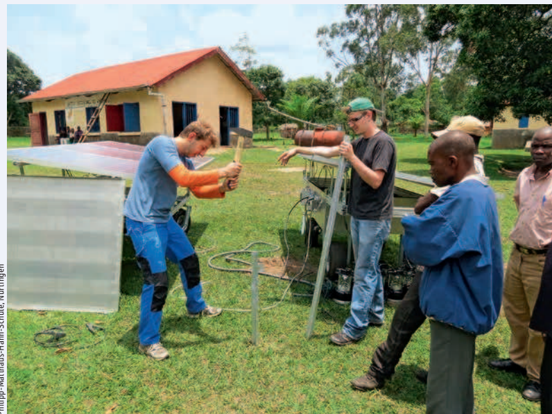
Christian Weinmann (links) und Florian Waimer von der Philipp-Matthäus-Hahn-Schule installieren einen Blitzableiter für die neue Solaranlage.
